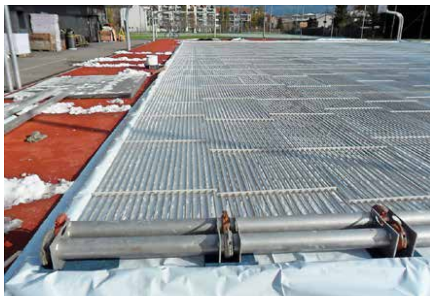
Für den Betrieb ist einiges an Technik nötig: Auf diese Saison hin wurde in eine neue Kühlanlage investiert.
