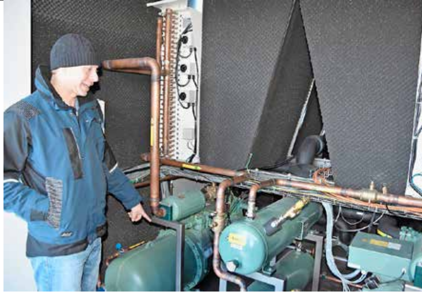
Blick hinter die Kulissen: Betriebsleiter Michael Roth erklärt die Kältemaschine.
